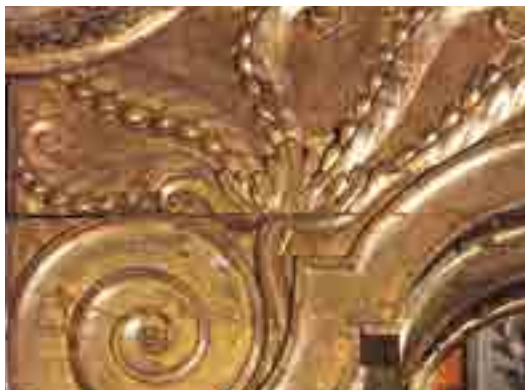
Fig. 21. Fronte sinistro, mensole, particolare della presenza di fessurazioni.
