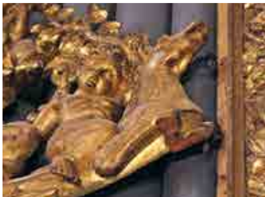
Fig. 20. Fronte principale, prima partizione, particolare della perdita di parti del modellato ligneo.
